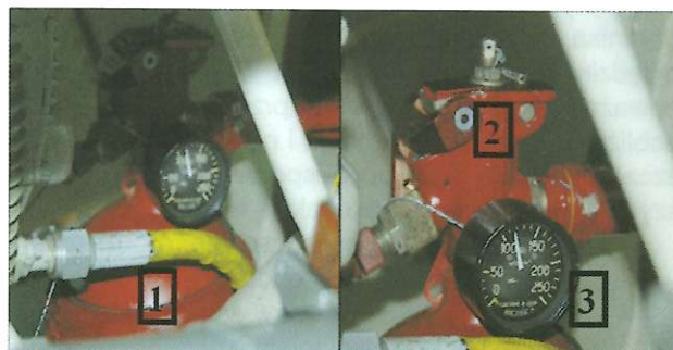
Ryc. 6. Instalacja stacjonarna gaszenia pożaru zawierająca zasobniki środka gaśniczego (1), pironaboje uwalniające środek gaśniczy (2), manometry wskazujące ciśnienie w butlach (3).
