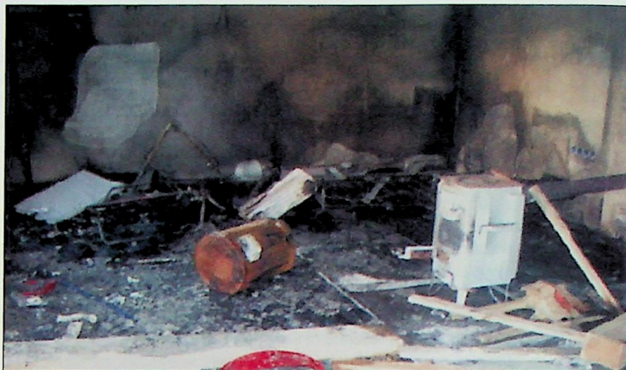
Ryc. 1. Wnętrze pomieszczenia po pożarze Fig. 1. View of interior after a fire
