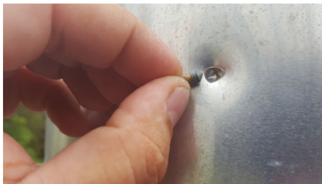
Ryc. B. Uszkodzenia powierzchni komina
