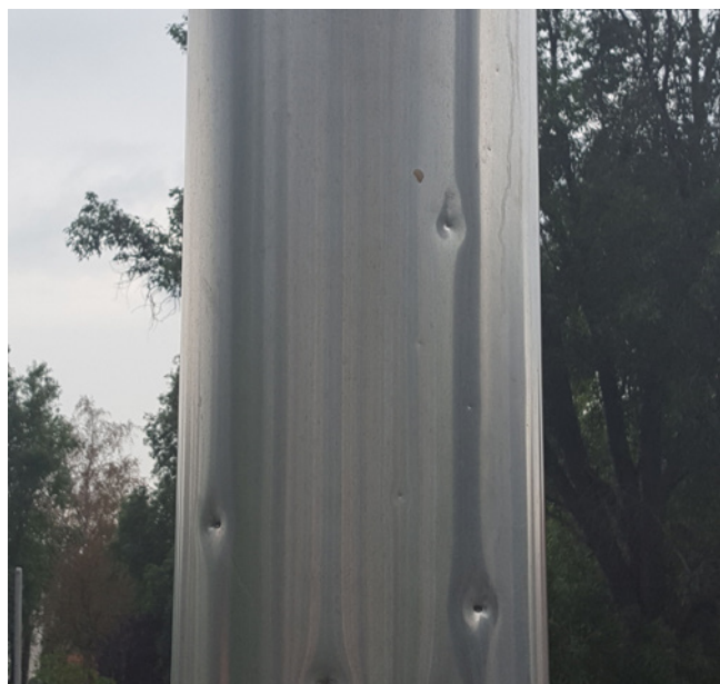
Ryc. A. Uszkodzenia powierzchni komina
